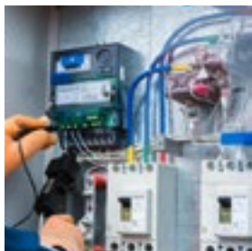
Узлы учёта электроэнергии
