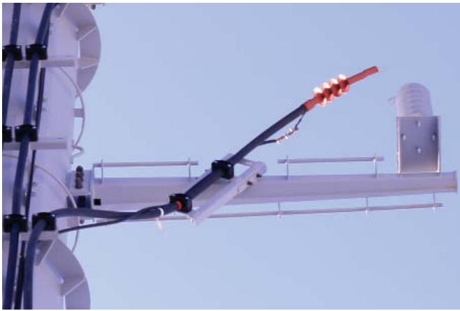
Рис. 3. Вывод экрана кабеля из концевой кабельной муфты — провод заземления ППС
