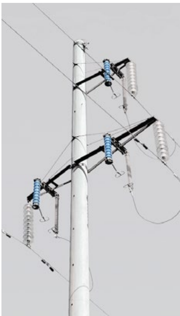
Фото 7. РМКЗ-110 на промежуточной опоре
