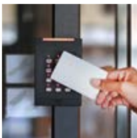
Системы контроля и управления доступом (СКУД)
