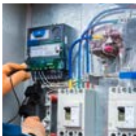
Узлы учёта электроэнергии
