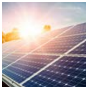
Солнечные электростанции, ветрогенераторы
