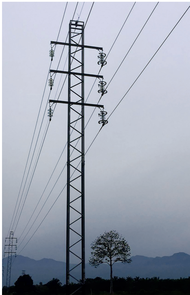
➤ Опора ВЛ 33 кВ в Малайзии, которая будет полностью оснащена РМКЭ-35 в рамках пилотного проекта с TNB
